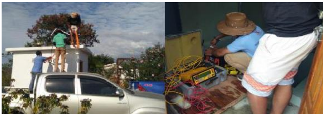
Instalação dos instrumentos de GPS permanente em Lacro
